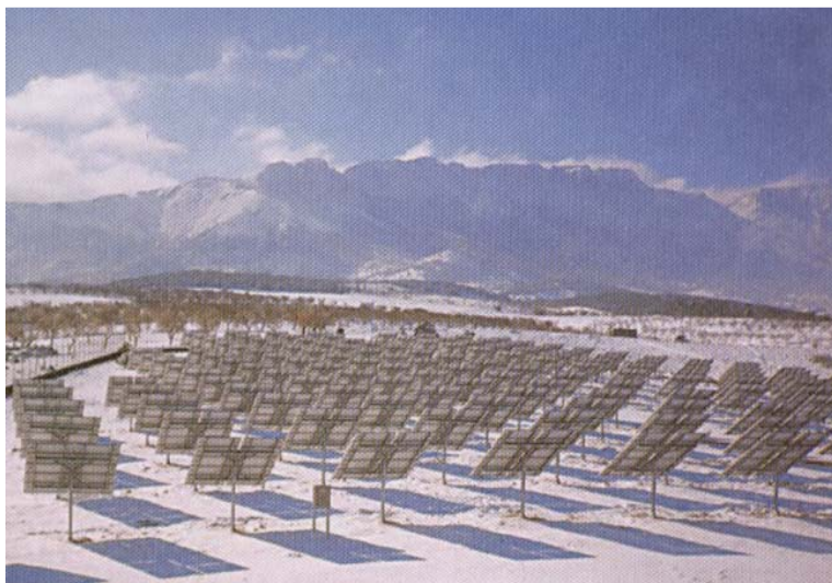
Figura 2.5.2.1.1. Paneles en Parque natural de Sierra Ma a . Fuente al pié*
