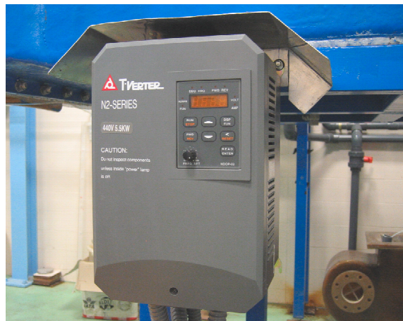
Figura 2.9: Variador de frecuencia T-VERTER modelo NDOP-02 de 5,5kw
