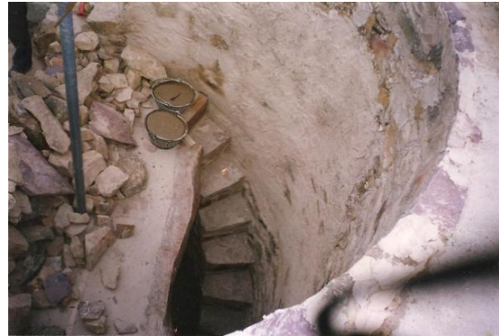
Figura 3.3. Estado de la escalera del molino antes de su rehabilitación [Ayto. El Granado]
