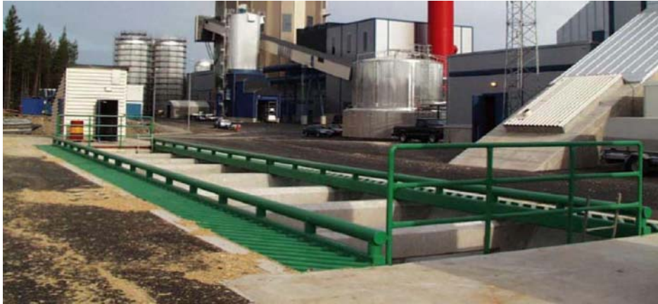
Fig1. Foso de recepción de biomasa triturada.
