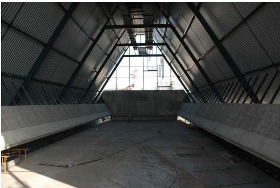
Fig.4. Vista interior de un silo de biomasa
