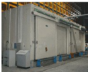
Fig.4. 56. Cámaras Frigoríficas. Fuente: Web
