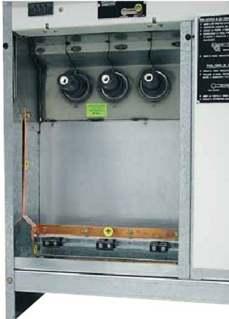
Compartimento de salida de cables en función de línea (I).
