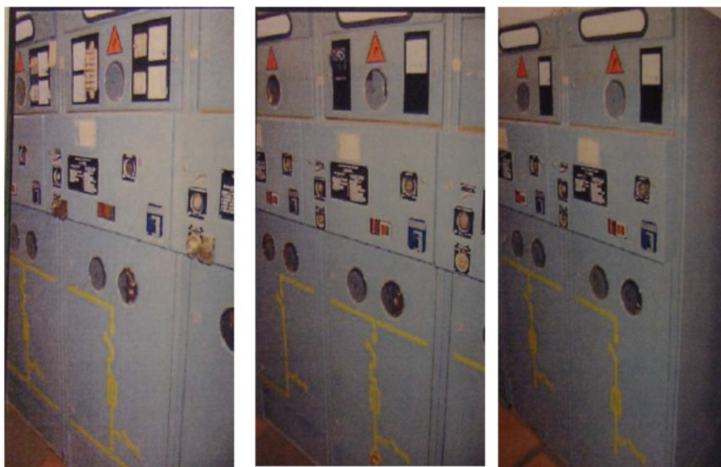
Figura 16: Cabinas M1 a M6 – 3 kV
