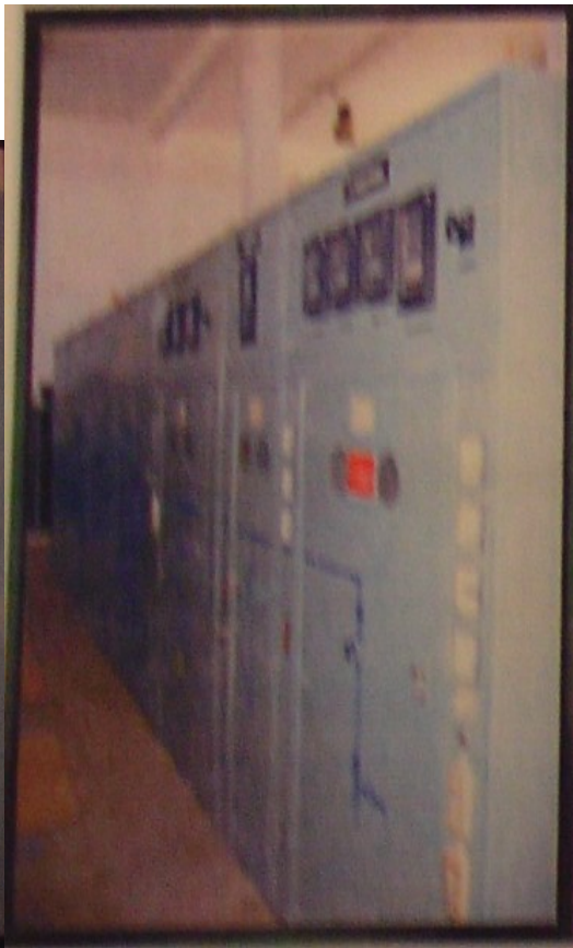
Figura 12: Cabinas A9 a A15 – 15 kV
