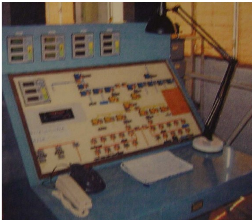
Figura 24: Sala de Control
