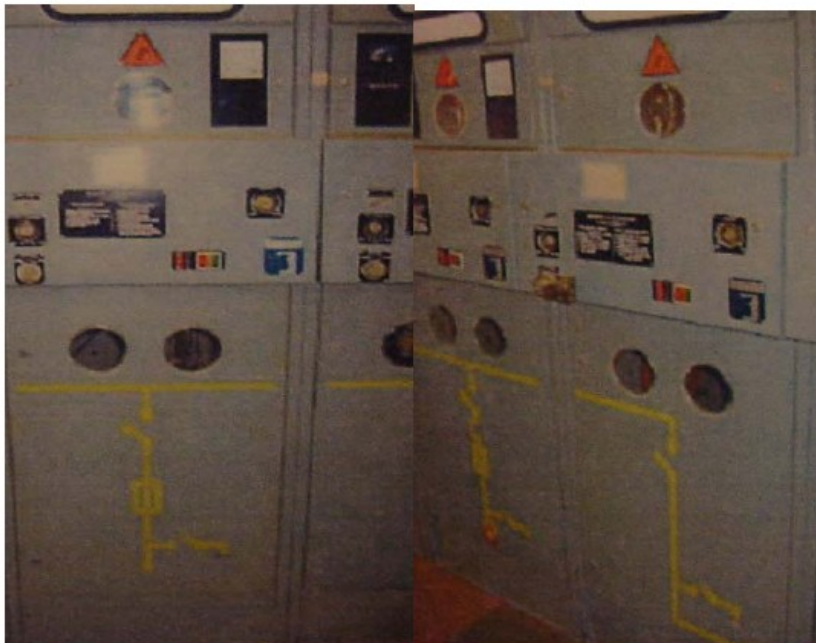
Figura 18: Cabinas M12, M10 y M11 – 3 kV
