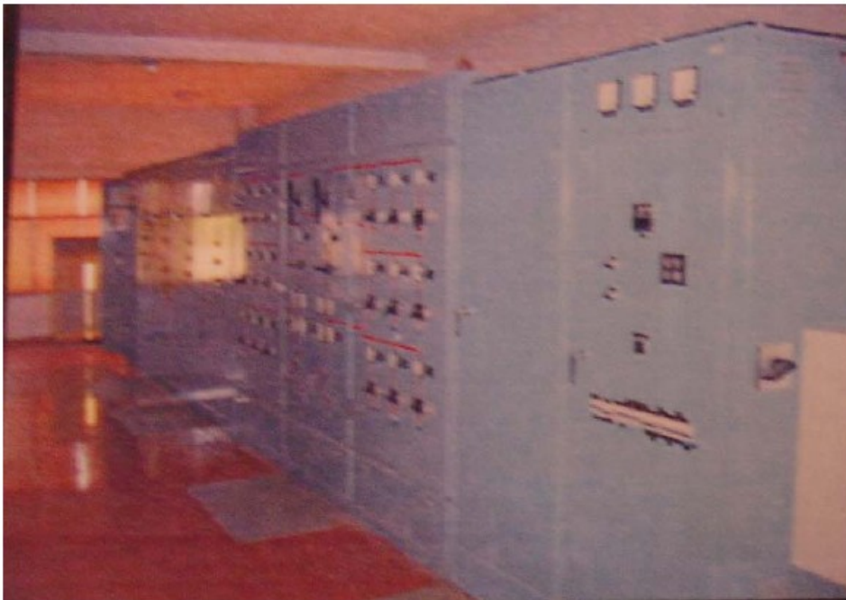
Figura 22: Paneles de control grupos de emergencia y secciones de control y entrada/salida Ges
