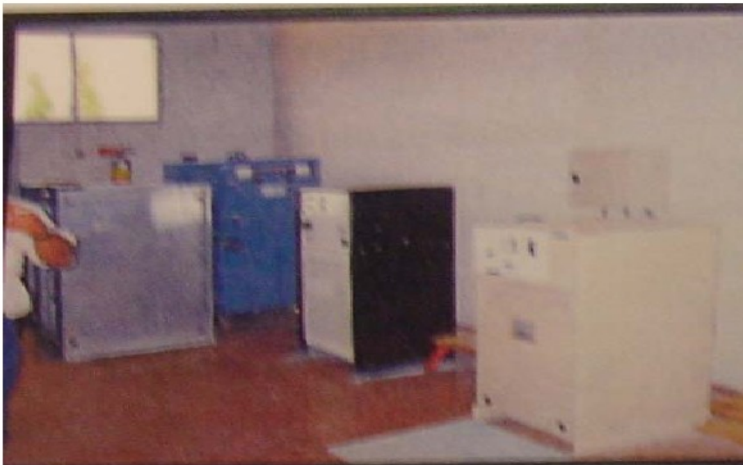
Figura 26: Sala de reguladores de balizamiento
