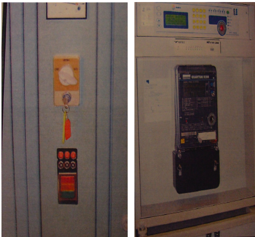
Figuras 14 y 15: Permisivo Acometida Base Aérea y Contador Compañía Acometida
