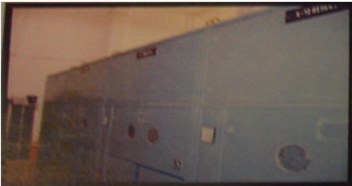
Figura 13: Cabinas de reserva A12 a A15 – 15 kV
