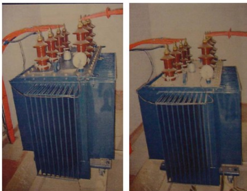
Figura 20: Trafos TM-1 y TM-2 3/0,4 kV
