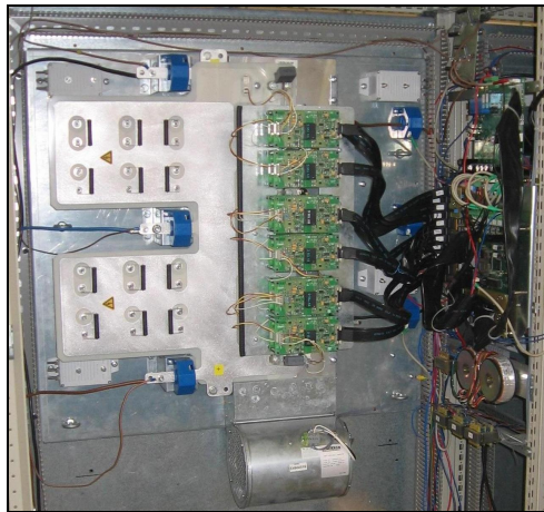
Figura 18 Prototipo de 150kVA y tres niveles Diode-Clamped usado en las pruebas.
